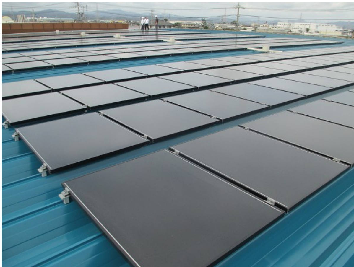
【設備全容】 南西から北東方向
