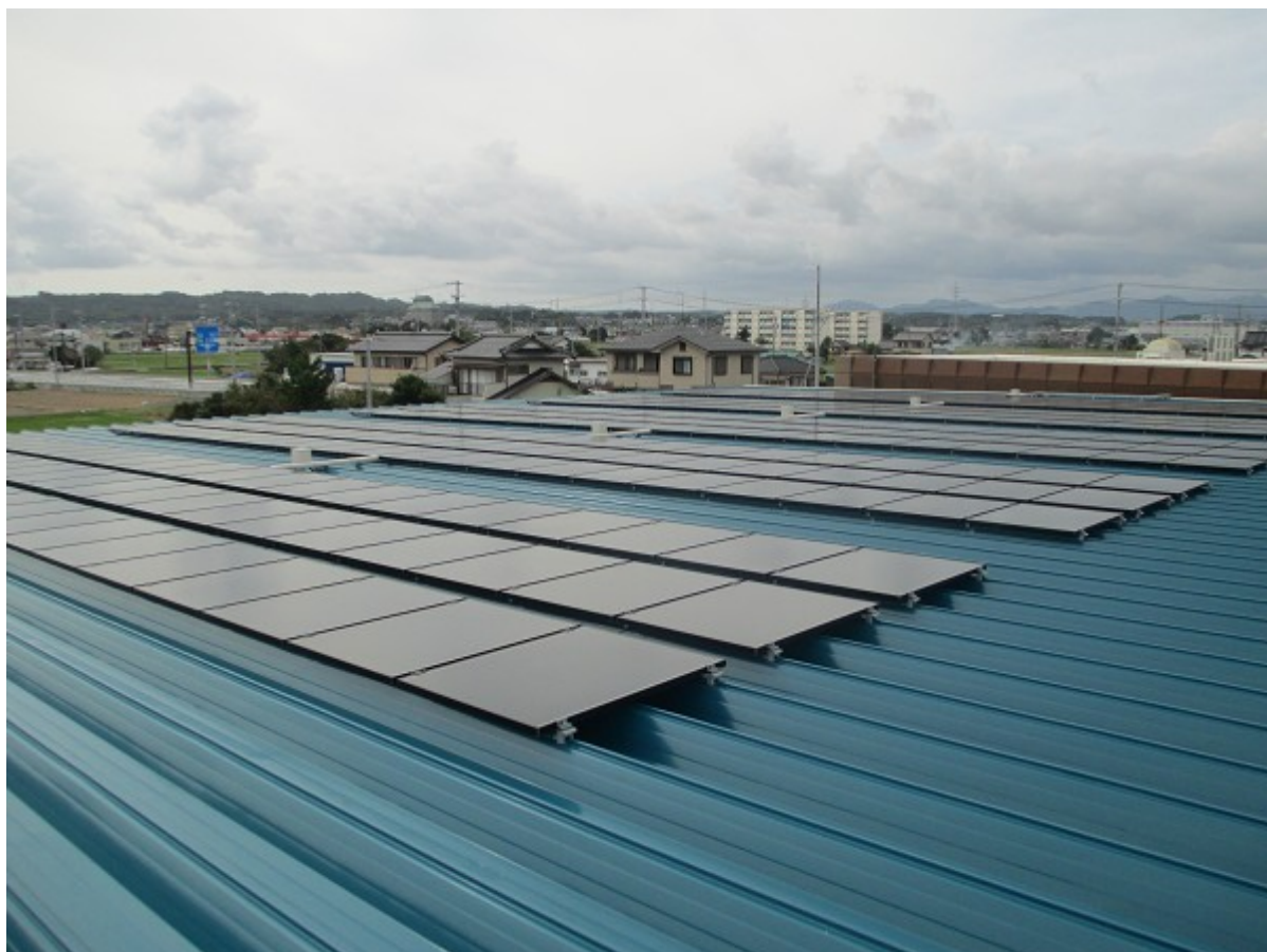
【設備全容】 南東から北西方向
