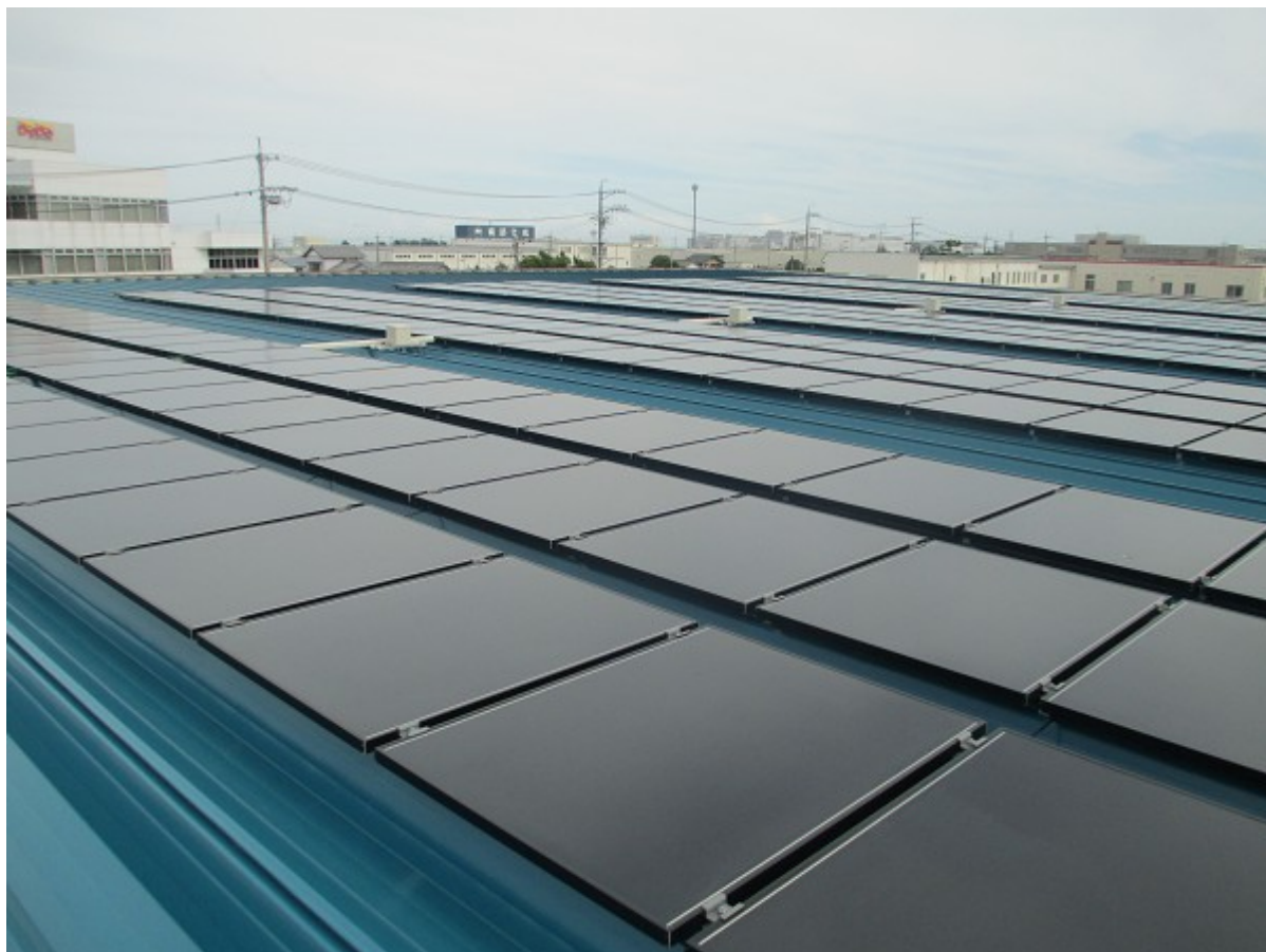
【設備全容】 北西から南東方向
